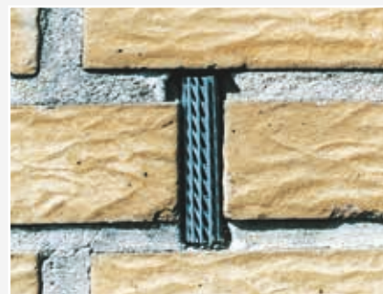
Studsugerør monteret i mur
